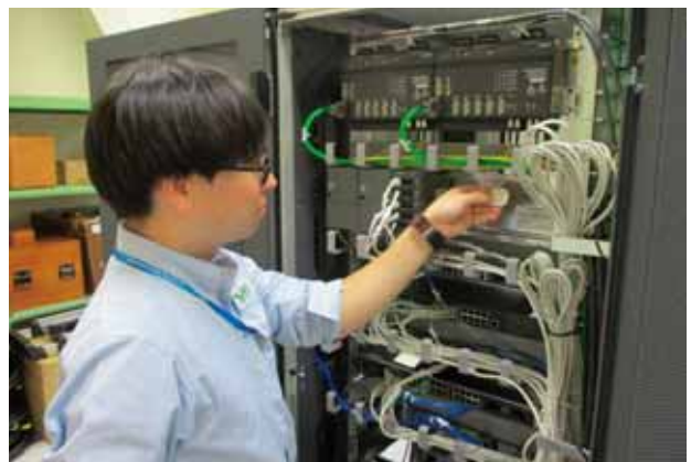
新規ネットワーク構築の接続を確認
