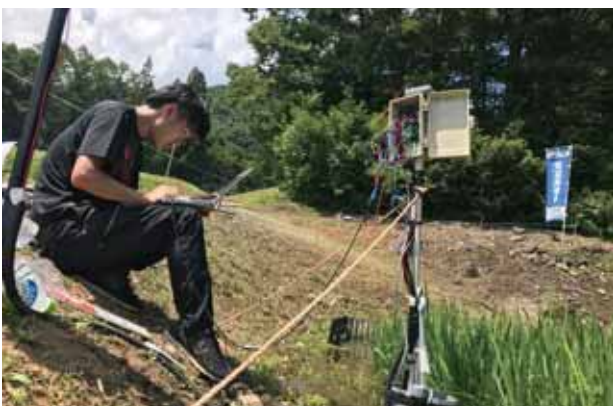
小谷村にて水田水位計測システムプログラム書き換え作業の様子
