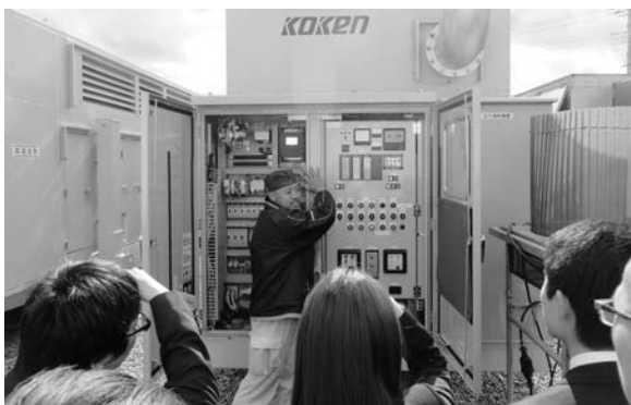
自揚型移動式高圧発電装置の制御盤
